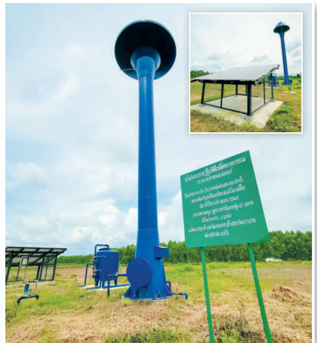
ระบบประปาบาดาลโซลาร์เซลล์ที่ ส.ป.ก.ดำเนินการออกแบบก่อสร้าง
